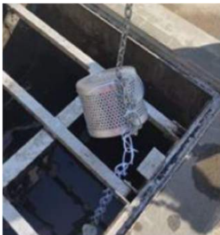
Figure 16 - Point de mesure sortie Biostyr
