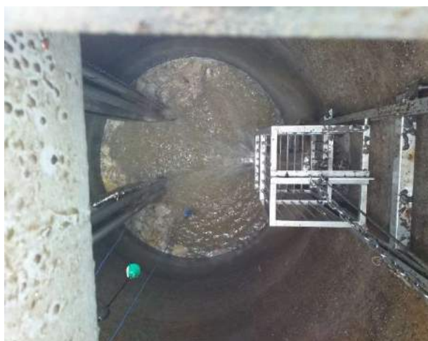
Figure 2 - PR Village - Saint-Drézéry - cuve avec panier dégrilleur
