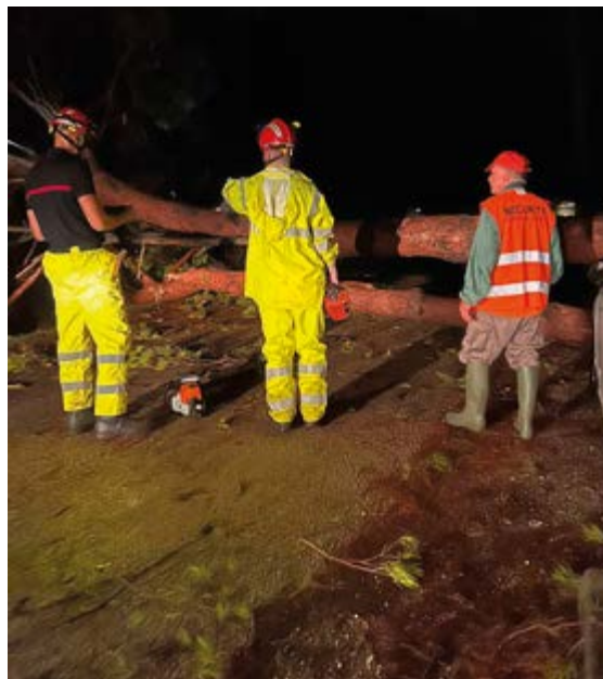
Phase 1 : recensement des dégâts pour prioriser les interventions d'urgence
